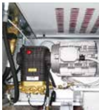
Деталь насосной системы
